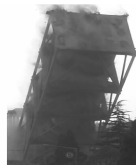
图10 钢塔架立窑倒塌瞬间
